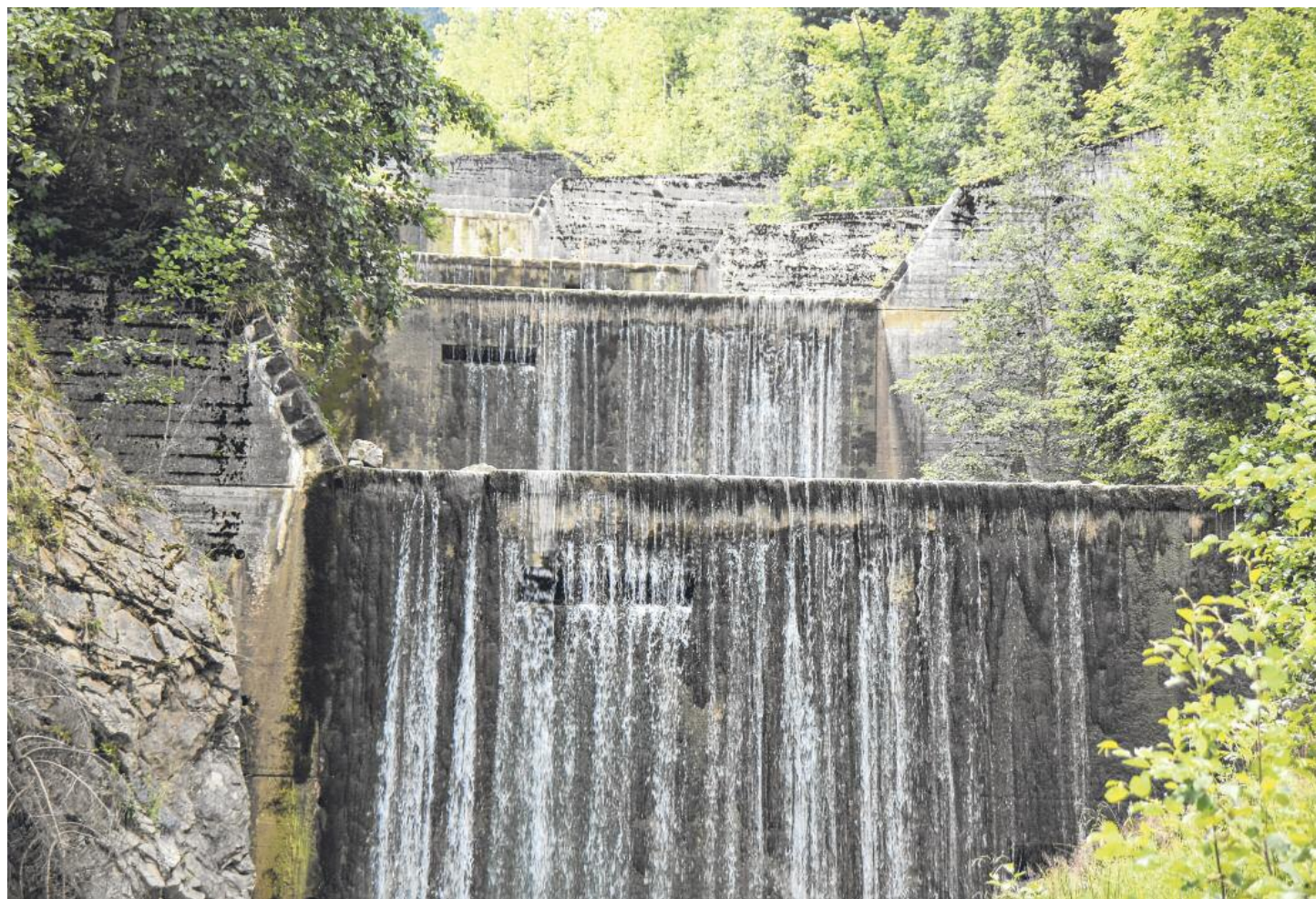
Die grossen Betonsperren am Oberlauf der Gürbe dienen dem Kampf gegen Hochwasser.
